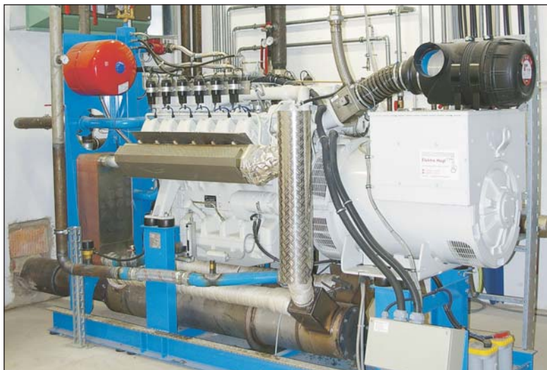
Der Gasmotor des Blockheizkraftwerks leistet 380 Kilowatt.
