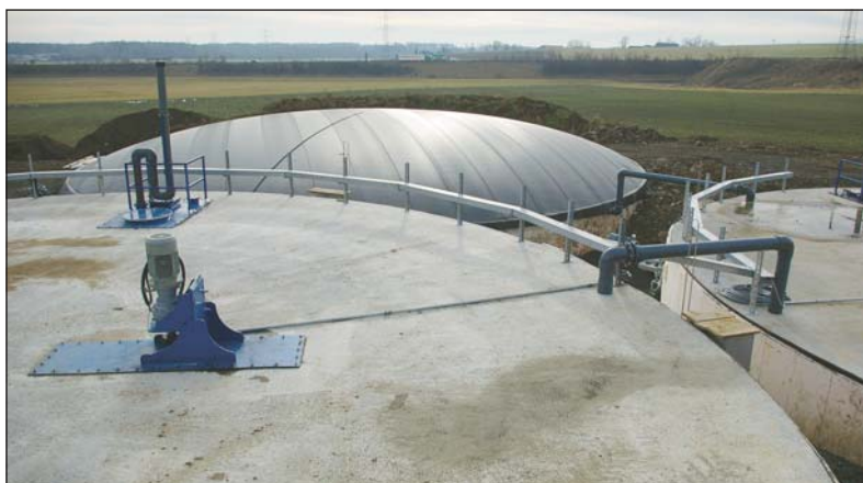
Aus drei Behältern besteht die Biogasanlage: zwei Fermenter mit Betondecke und ein Endlager mit Folienhaube.
