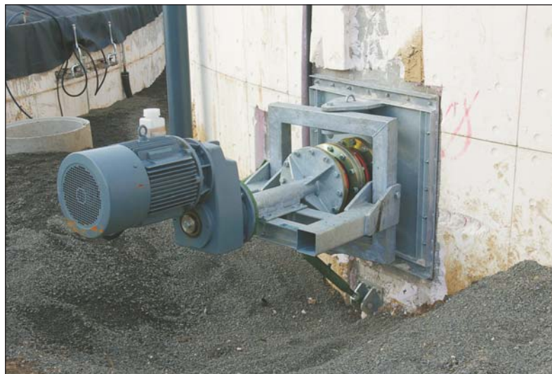
Ein Stabbrührwerk in jedem Fermenter ergänzt das Paddelrührwerk.
