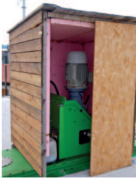
Auf der Betondecke des Fermenters ist der Antrieb des stehenden Paddelrührwerks gut zugänglich.
